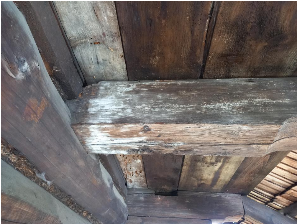
Chałupa z Bażanowic, korozja biologiczna drewna desek okapowych oraz tragarzy
