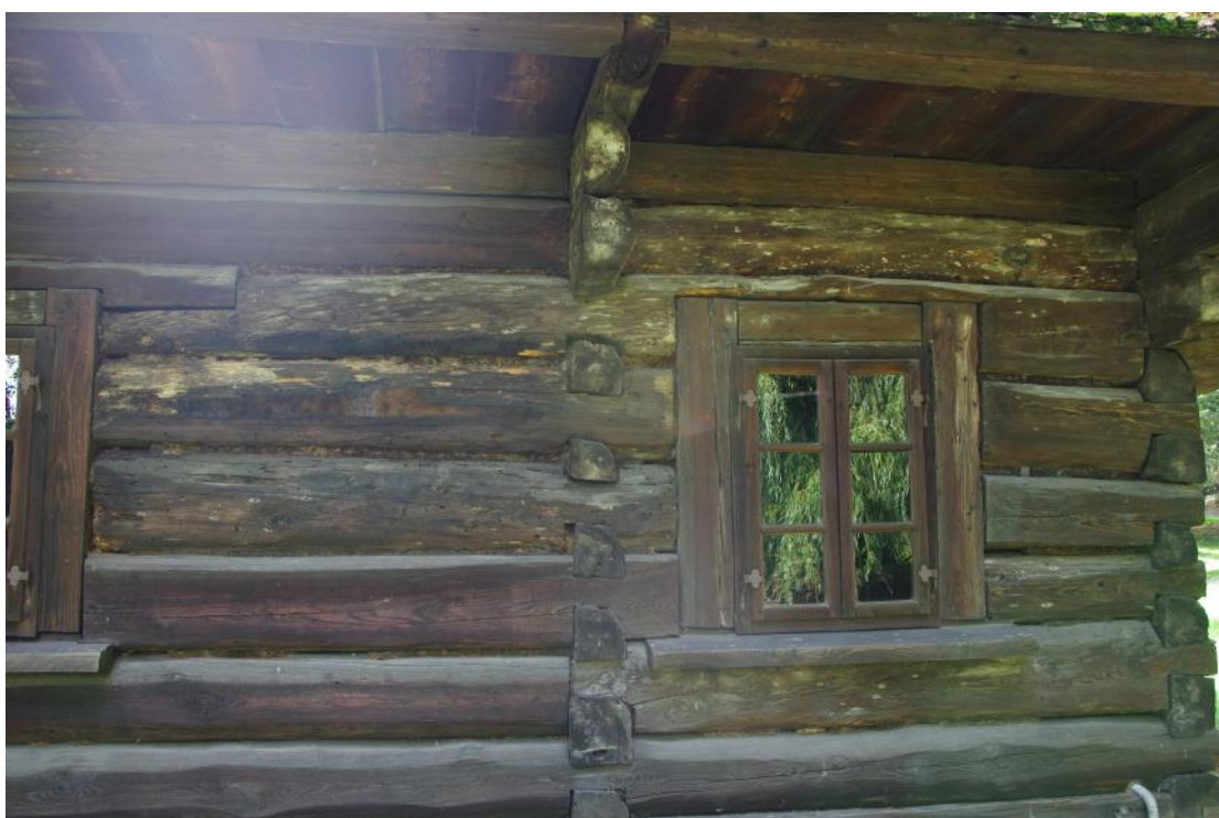
Chałupa z Bażanowic, ściana szczytowa, degradacja biologiczna górnych belek zrębu
