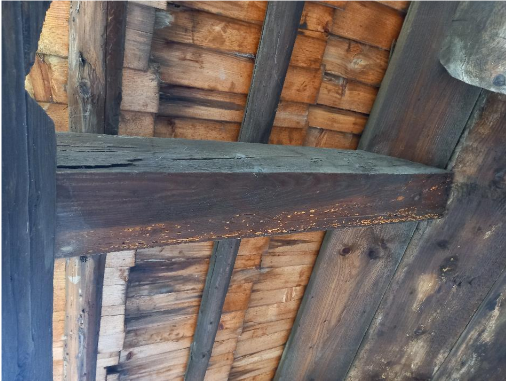
Chałupa z Bażanowic, krokiewka ganeczku, widoczna korozja biologiczna
