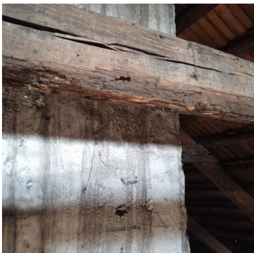
Stan zachowania najbardziej uszkodzonych jętek
